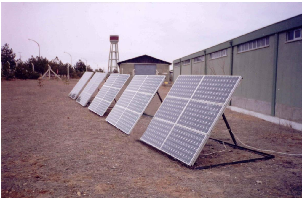
Рисунок 2. Сонячні батареї водневої заправної станції.
