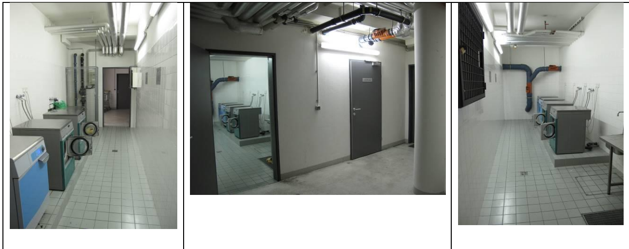
Рис.5. Пральня в підвальному приміщенні житлового будинку у Відні. Обладнання – два пральних автомати, дві сушарки і стіл з раковиною. В підлозі передбачено трап. Для зручності користування пральні автомати і сушарки встановлено на невеличкому подіумі.
