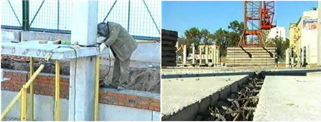
Рис.9. Вигляд елементів надколонних плит і стиків між плитами і з колонами в процесі монтажу.
