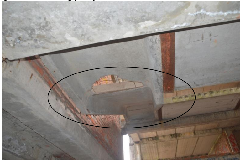
Фігура 6. Сходовий марш. Руйнування захисного шару бетону. Поздовжні тріщини. Руйнування сходових майданчиків
