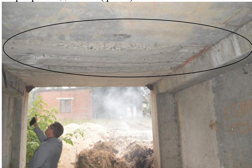
Фігура 5. Візуальне спостереження провисання плити перекриття
