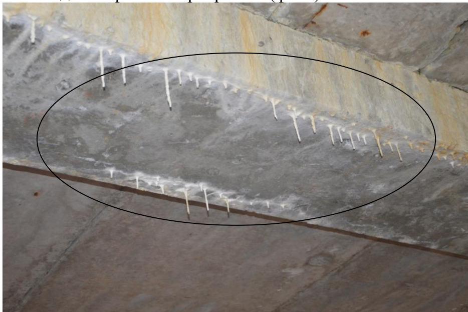
Фігура 2. Ригелі перекриття. Руйнування захисного шару бетону. Вилужування бетону.
