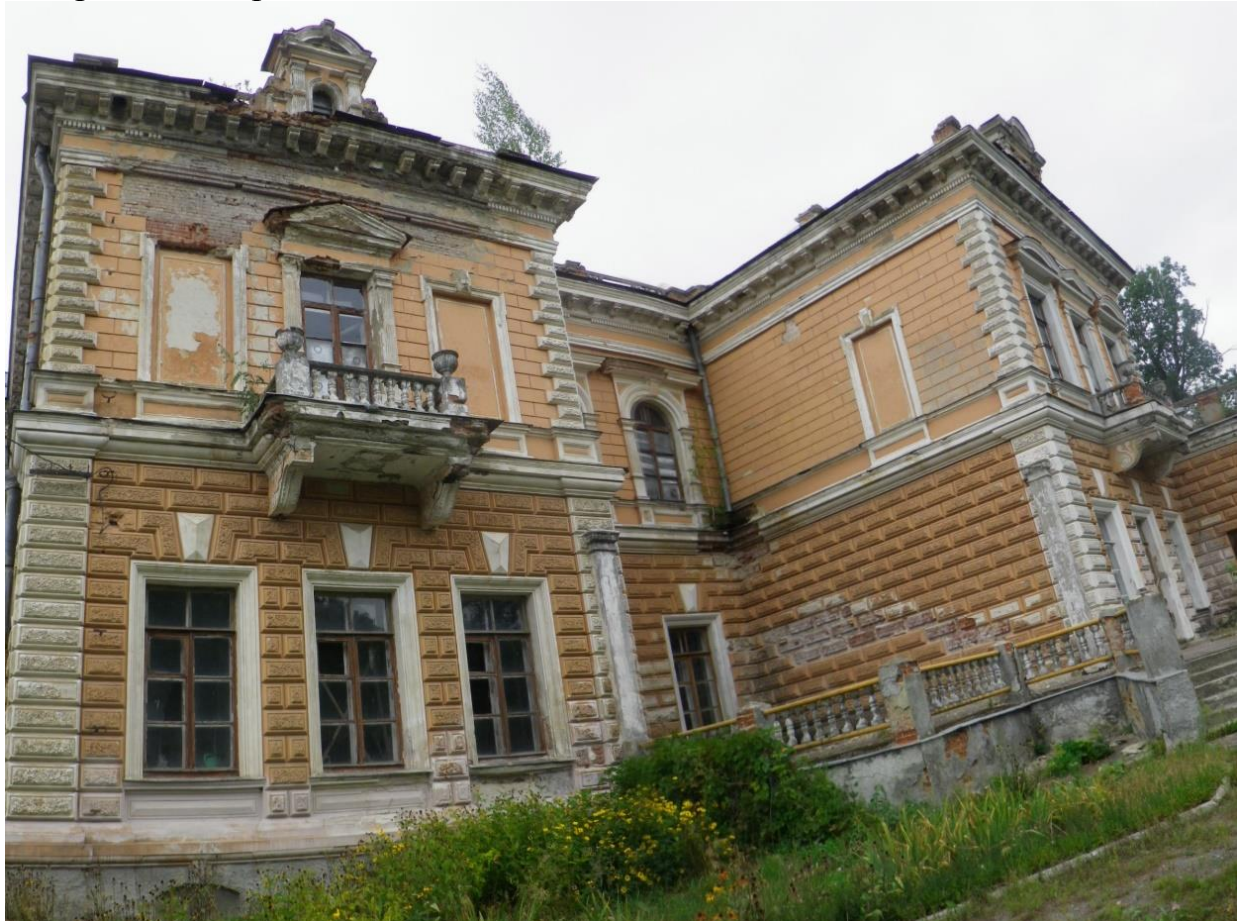
Фігура 10. Фрагмент бокового фасаду. Руйнування балкона. Руйнування карниза. Відсутність конструкцій відливу. Відсутність захисного шару. Відсутність водовідвідної системи труб (зливові труби).
