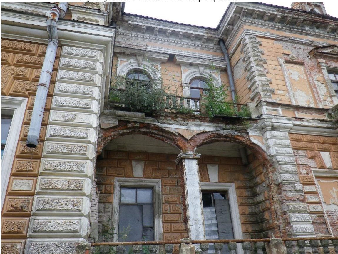
Фігура 9. Фрагмент бокового фасаду. Руйнування лоджії, що підтримує арки, опорний крон арки. Руйнування карниза. Відсутність конструкцій відливу. Відсутність захисного шару. Біологічна корозія, відсутність водовідвідної системи труб (зливові труби). Руйнування перил і балюси лоджії та ганку.
